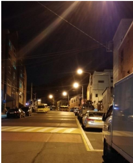
대상지역(만덕동) 가로등(나트륨 이온등)
